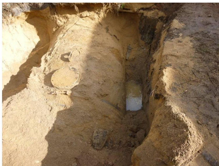
La cuve est apparente
