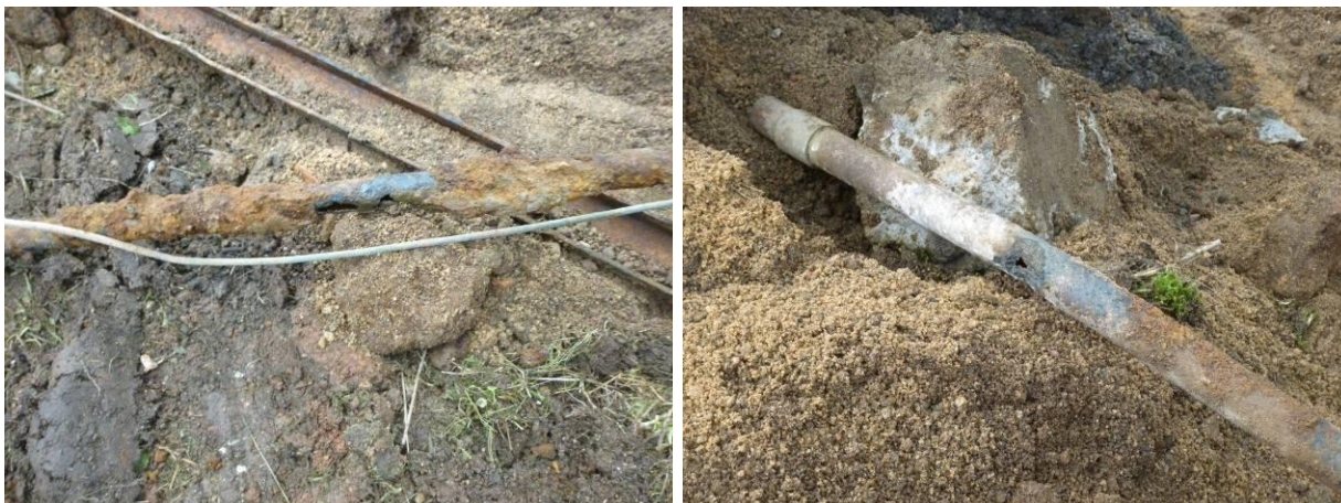
Les tuyaux sont percés
