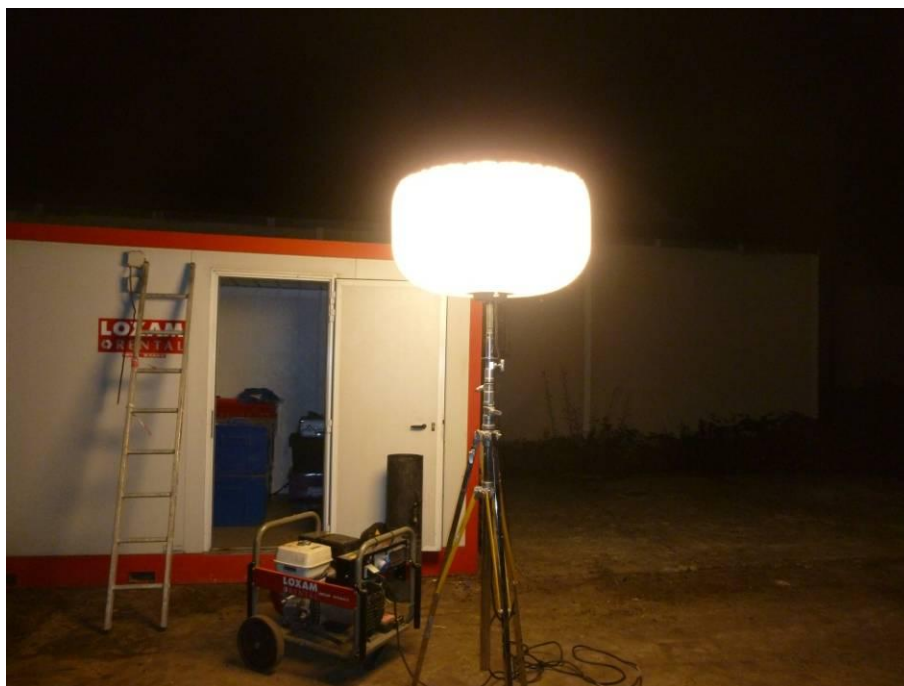
L'éclairage de la base de vie pour la prise de poste et fin de journée
