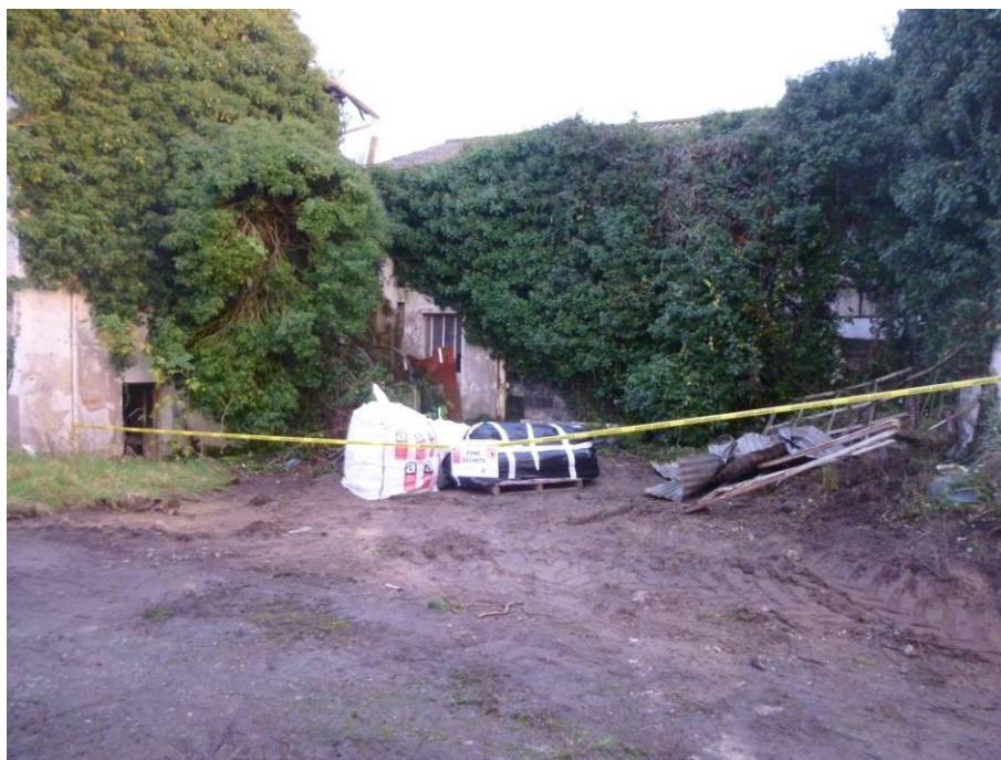
Aire spécifique de stockage des déchets amiantés
